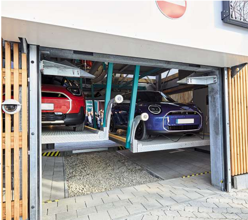
Der PKW-Paternoster ist auf Fahrzeuge mit einer Höhe bis 1,74 Meter und einer Breite bis 2,20 Meter ausgelegt.
